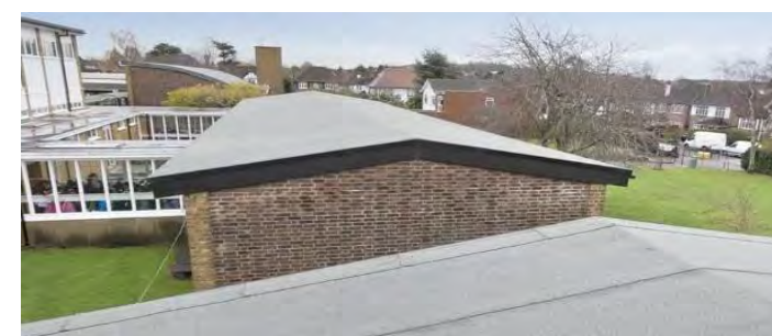
CO2 opnemende daken
